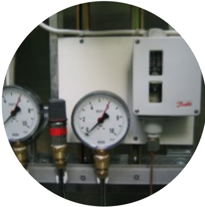
Instrumentointi ja mittaukset keskitetty seinätelineeseen
