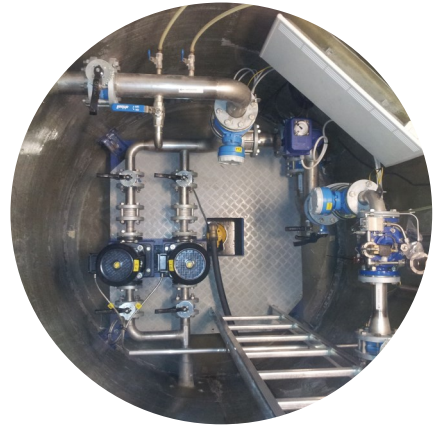
Alavesisäiliön paineenkorotus- ja mittausasema
