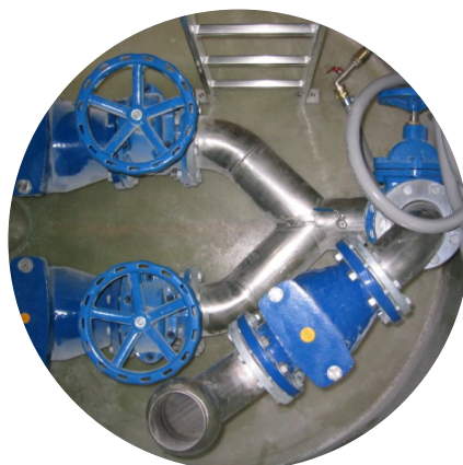
Venttiilitila voidaan varustaa myös loka-autoliitännällä
